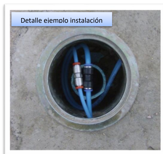
Ilustración 2. Red de canalización de aire comprimido en piezómetro de 2"
